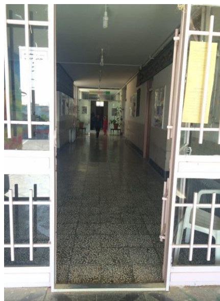
شکل ۸. مصالح نامناسب کف در دبستان ناشنویان اصفهان (مرکز ۲)
